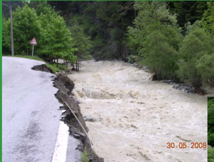
Valle Maira: erosione S.P. Canosio-Marmora (alluvione maggio 2008)
