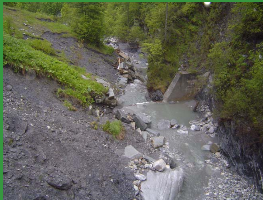
Bellino loc. Pleyne: aggravio frana esistente (alluvione maggio 2008)
