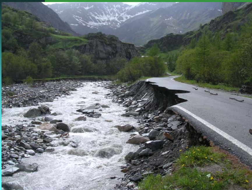
Bellino: erosione S.P. per S. Anna (alluvione maggio 2008)
