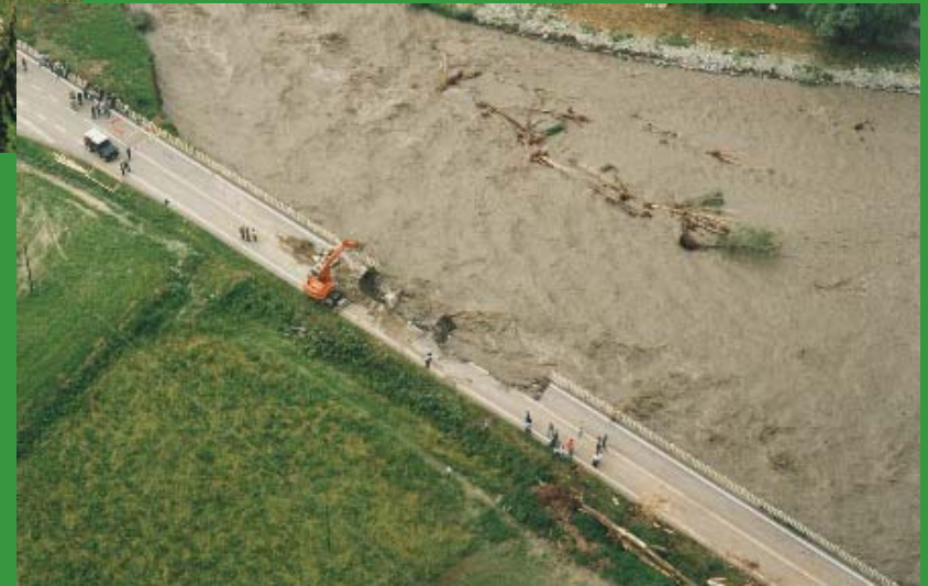
Valle Varaita: foto aerea danni strada provinciale (alluvione 2000)
